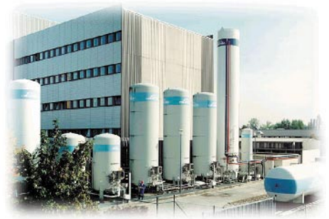
Gaseversorgung von Linde
