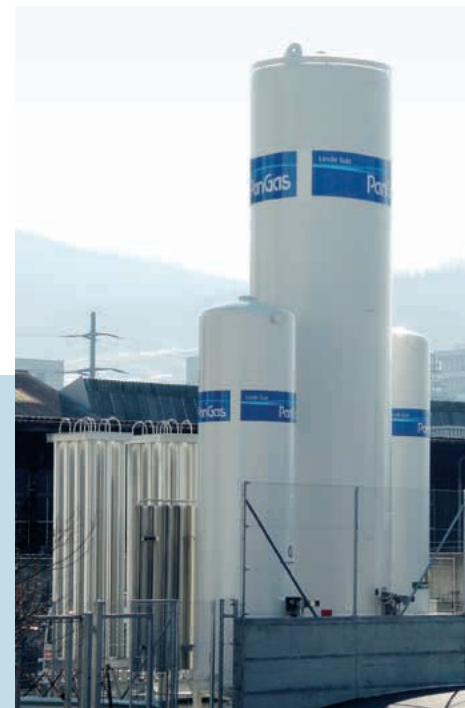
Tankanlagen für tiefkalt verflüssigte oder komprimierte Gase
