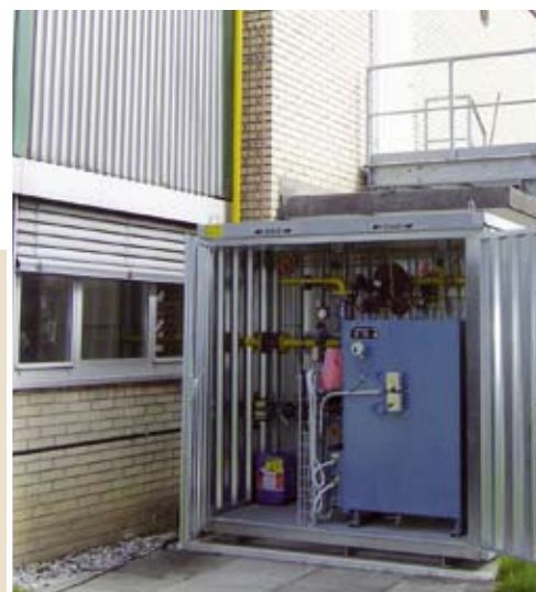
Unité de vaporisation
