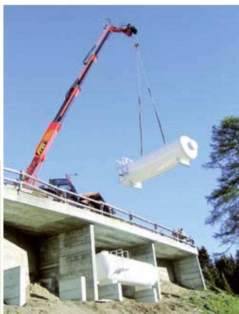
Approvisionnement en gaz pour un hôtel et un restaurant avec 2 réservoirs de 10 m 3
